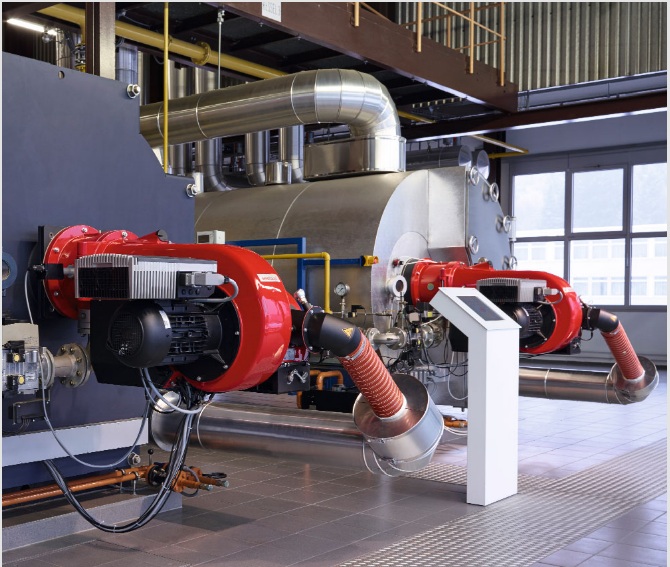
Langzeittest in der werkseigenen Heizzentrale
