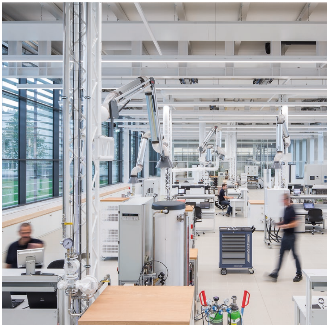
Proefbanken voor verwarmingssystemen
